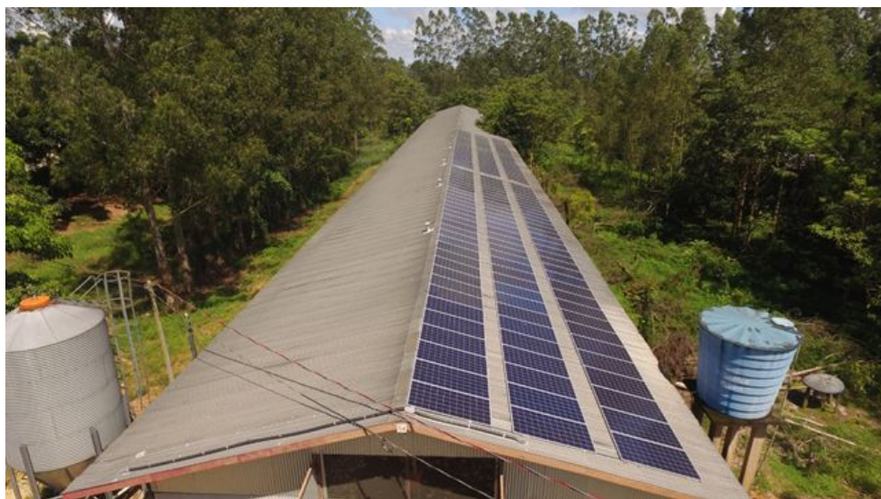
Usina solar em aviário
